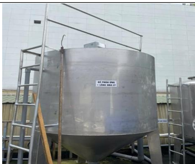
Bể phản ứng hóa lý
