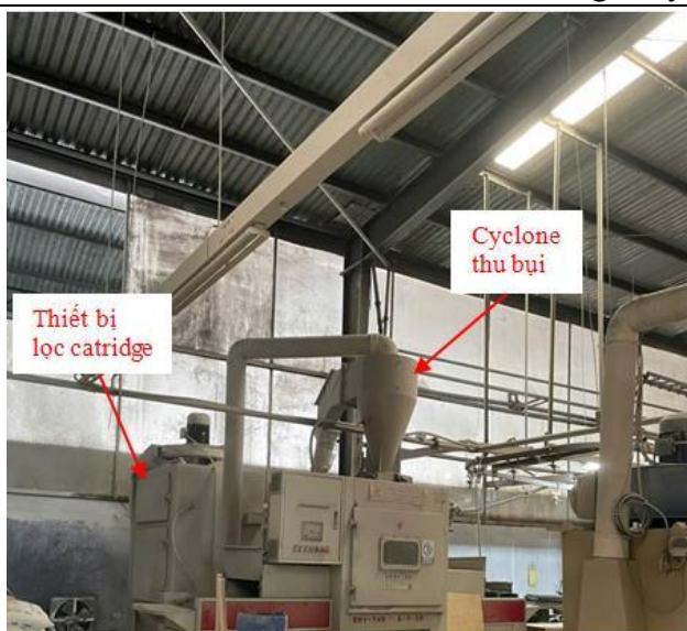
Thiết bị thu bụi 1 bằng cyclone kết hợp lõi lọc cartridge
