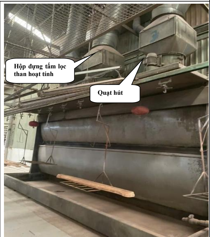
Hình 3.9. Hình ảnh khu vực hệ thống xử lý bụi sơn, hơi dung môi
