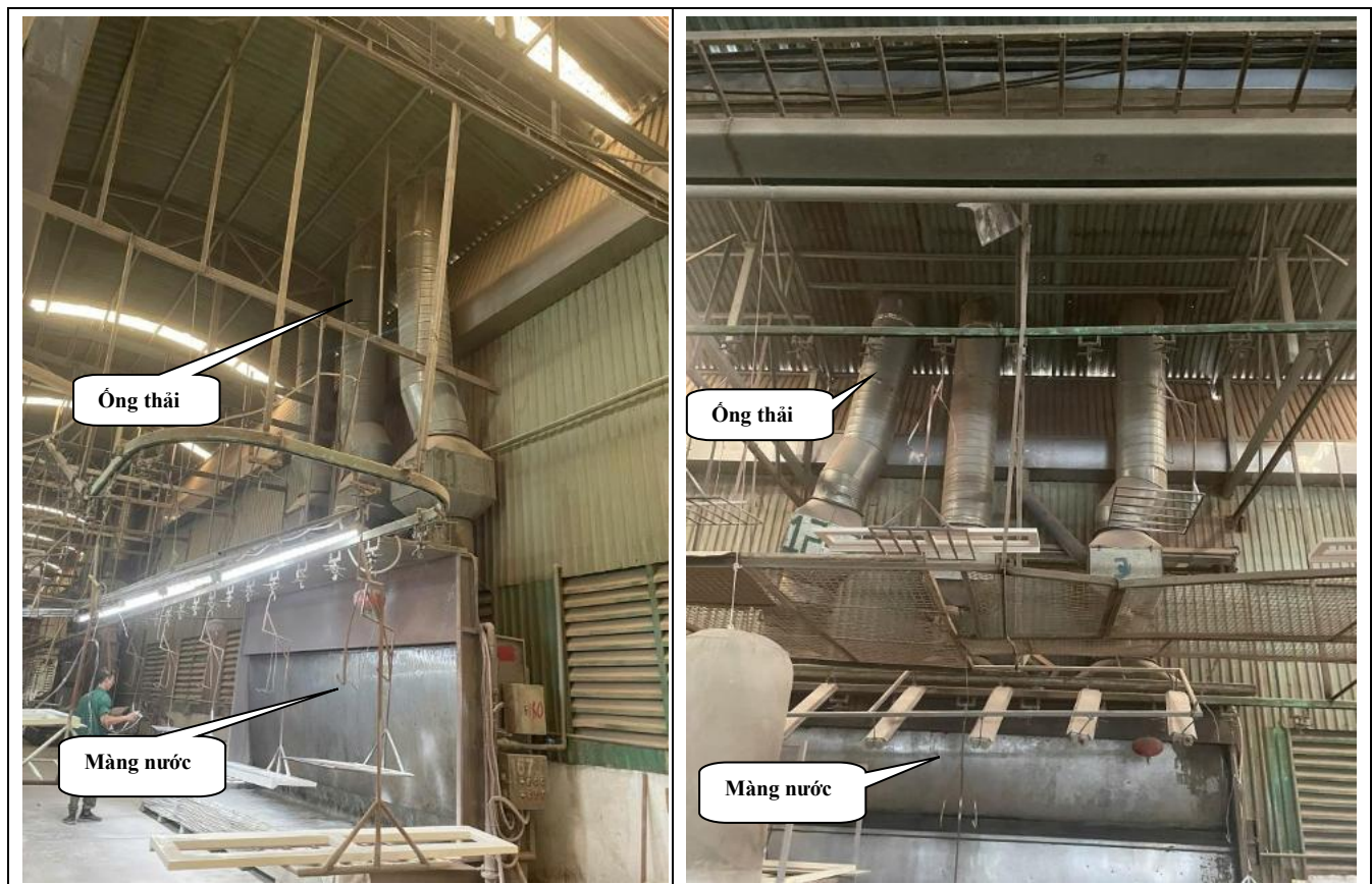
Hệ thống màng nước kết hợp than hoạt tính
