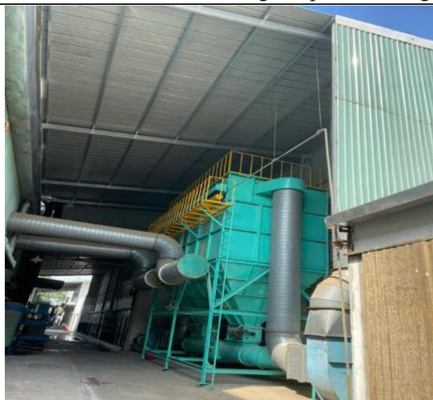
Hệ thống xử lý bằng thiết bị lọc bụi túi vải 1
