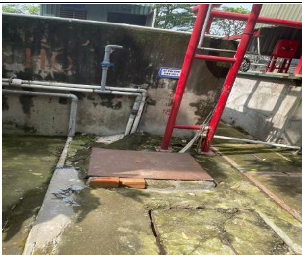
Bể thu gom nước thải đầu vào
