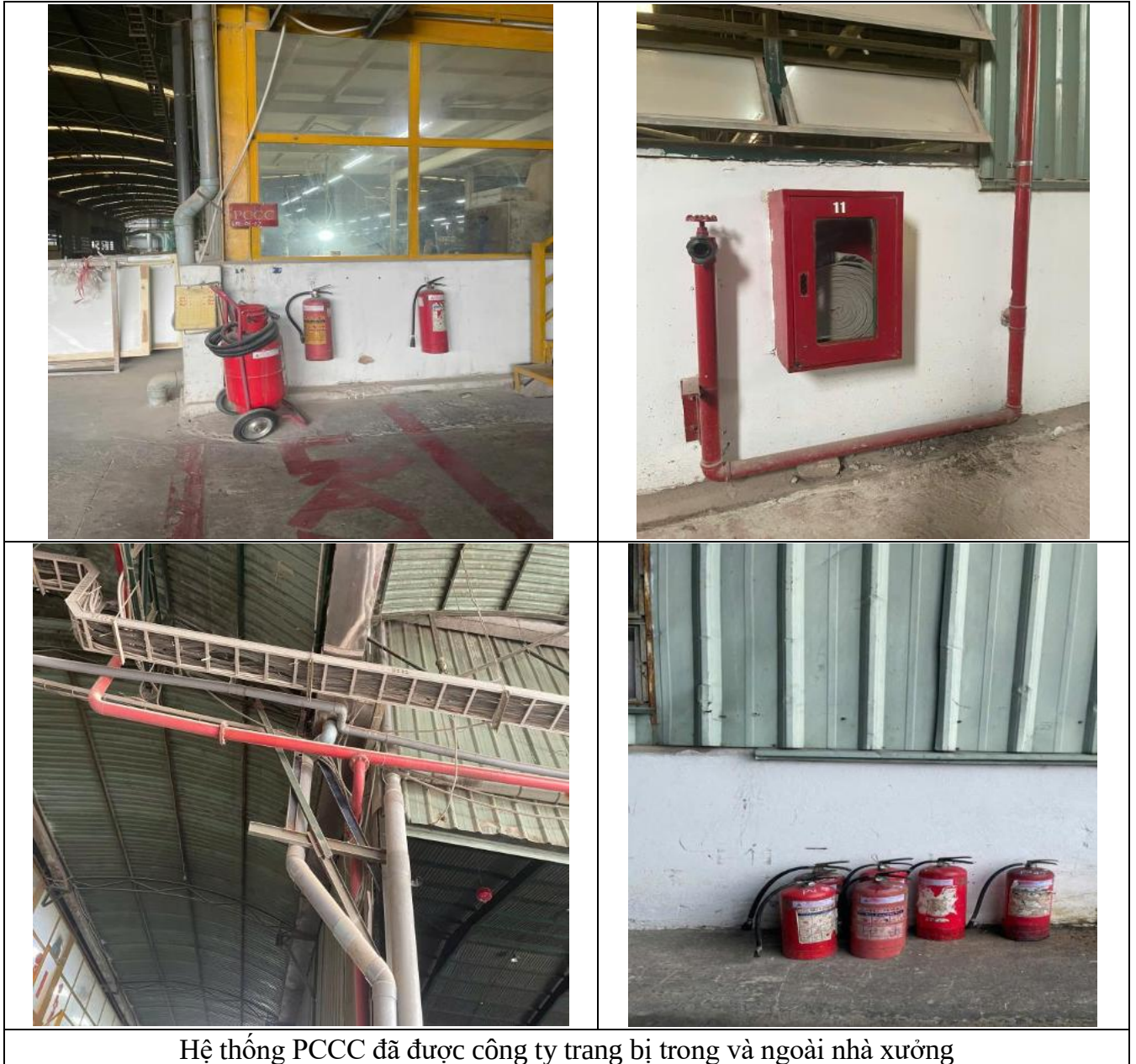
Hình ảnh về phòng cháy chữa cháy đã lắp đặt:
