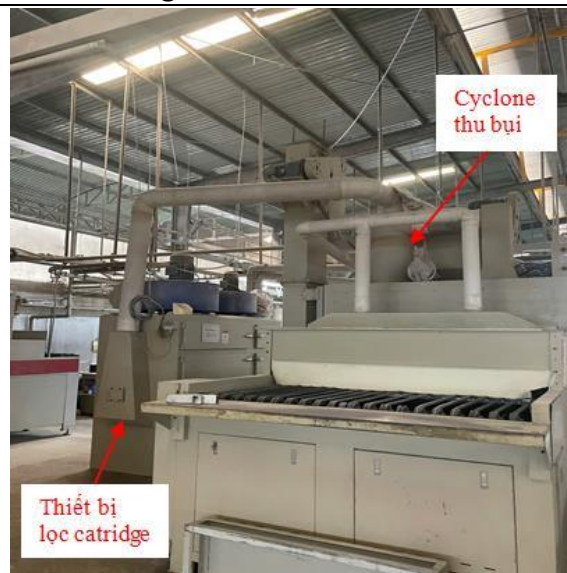
Thiết bị thu bụi 2 bằng cyclone kết hợp lõi lọc cartridge
