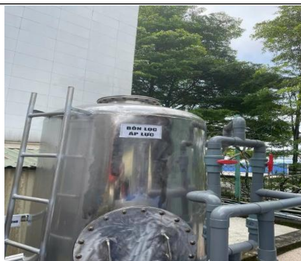
Bồn lọc áp lực
