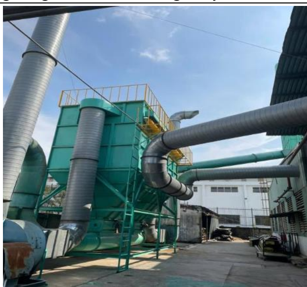
Hệ thống xử lý bằng thiết bị lọc bụi túi vải 2
